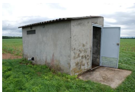
Prise incendie de 100 mm alimentée par une pompe agricole électrique
