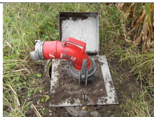
Puits agricole équipé d'un raccord intermédiaire de 100 mm
