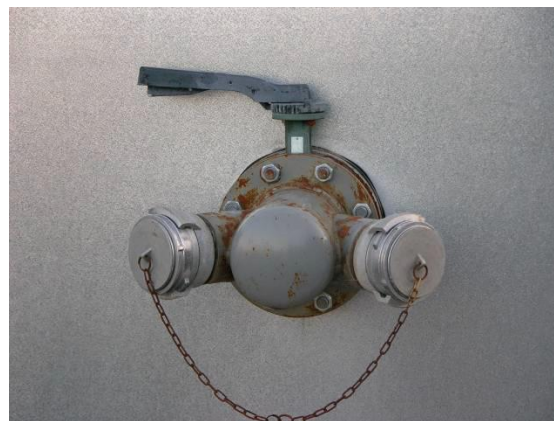
Prises directes de 100 mm sur réservoir aérien
