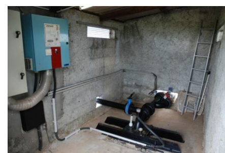
Vanne d'alimentation de la prise incendie
